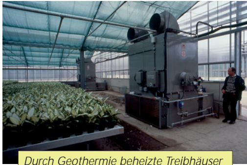
Durch Geothermie beheizte Treibhäuser in der Toskana, Italien (Foto F.-D. Vuataz)
